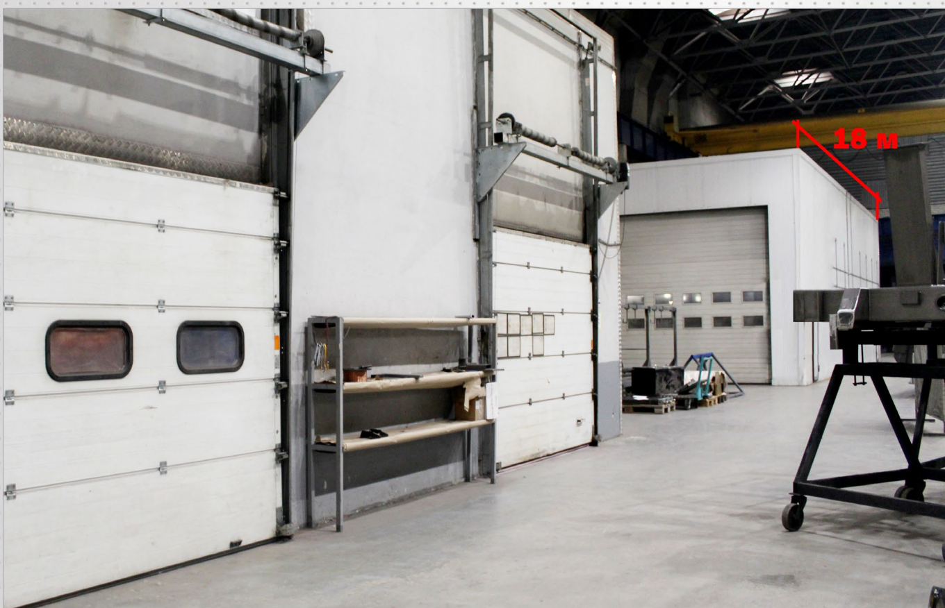
Комплекс из трех окрасочных камер размером 6 м, 6,8 м, 18 м и одной дробеструйной камеры длиной 14 м.
